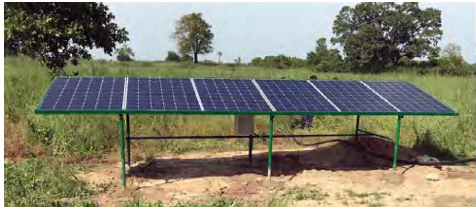
Senegal: Dörfliche Wasserversorgung
